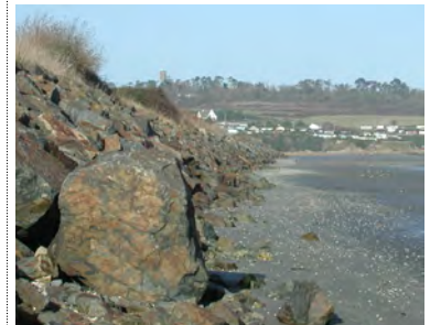
La digue de la décharge de la grève des courses était perméable aux polluants qui migraient vers la mer. Il est possible qu'au fil des années un colmatage de cette digue puisse conduire à son imperméabilisation.
