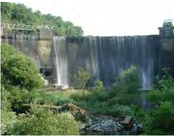
Les barrages successifs de Pont-Roland et des Pont-Neufs sont des obstacles majeurs à la libre circulation des eaux et à la migration de la faune. En outre ces deux ouvrages entraînent une profonde perturbation du régime hydrologique du cours d'eau.
